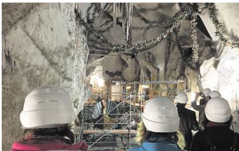
Die Tagungsteilnehmer machten sich ein Bild vom Zustand der Venusgrotte. Teile der Drahtputzdecke fallen immer wieder herab. Foto: Spangenberg
